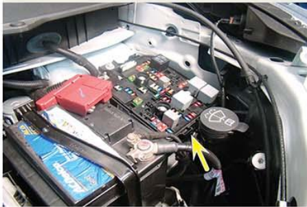
Localização da central do vão do motor
